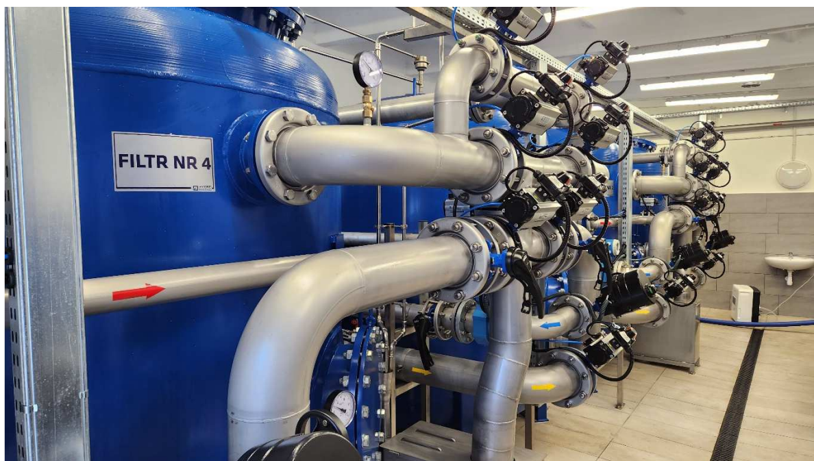
Stacja uzdatniania wody w Piotrowie gm. Brodnica
